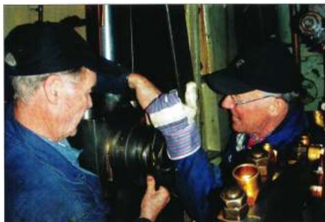
Under renoveringen av lågtryckscylinderns kolstäng sätts tvärstycket på plats av fr. v. Mats Demker och Håkan Rosell. Foto Bengt Sjöberg januari 2008
